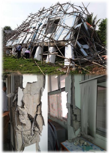
ภาพความเสียหายอาคารจากแผ่นดินไหวที่จังหวัดเชียงราย
