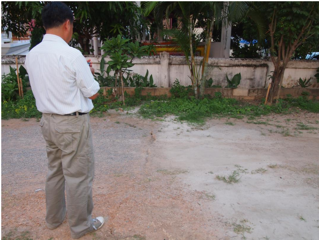
รูปที่ 6-11 การเกิด Liquefaction บริเวณผิวดินที่หลุมเจาะ BH-4
