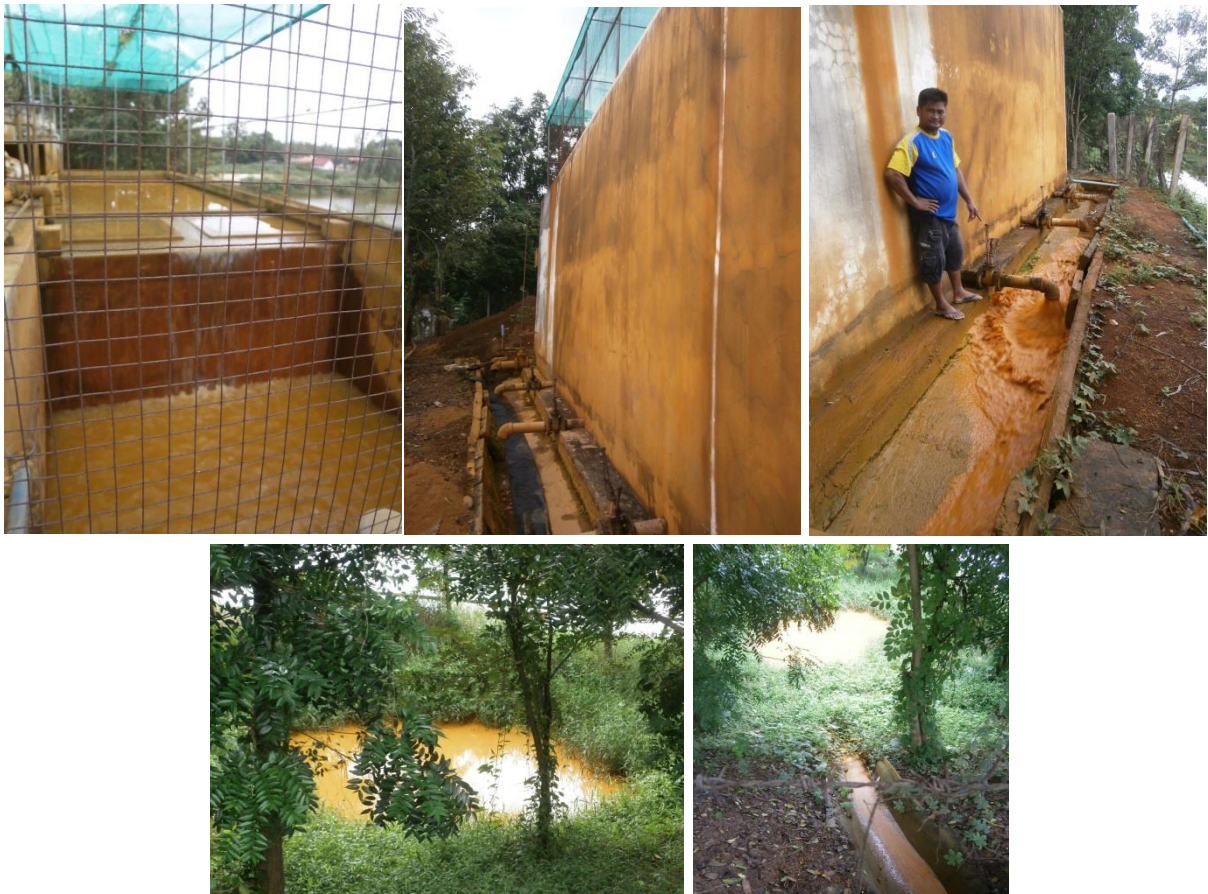
ภาพ 14-18 ระบบประปาบาดาลชนิดบ่อกักตะกอนที่มีเหล็กออกไซด์ปนเปื้อน
