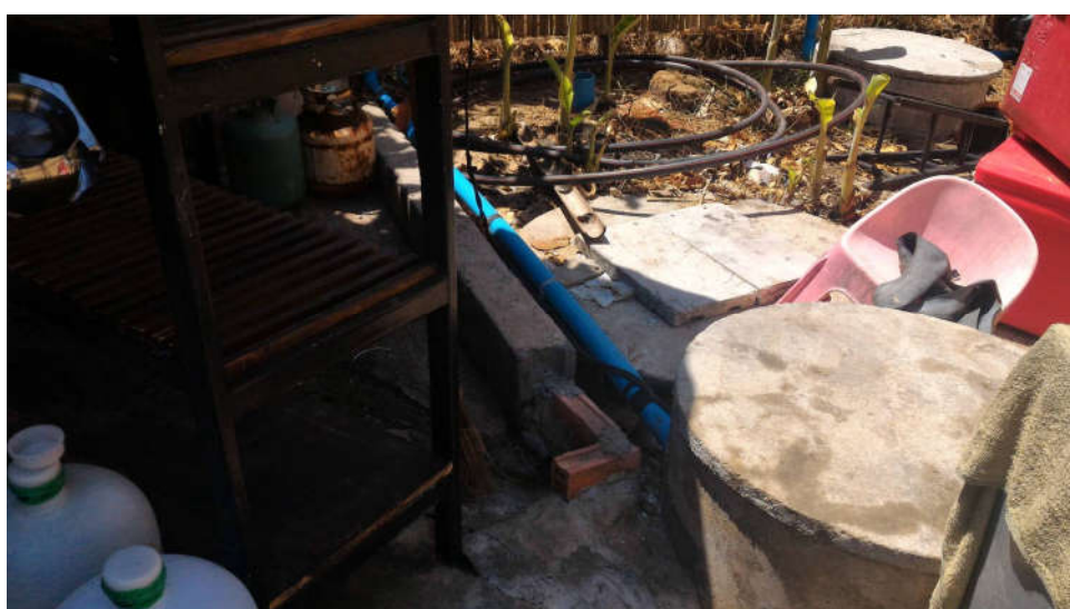
ภาพที่ 4.50 บ่อรับน้ำเสียจากห้องครัวให้ซึมลงดิน
