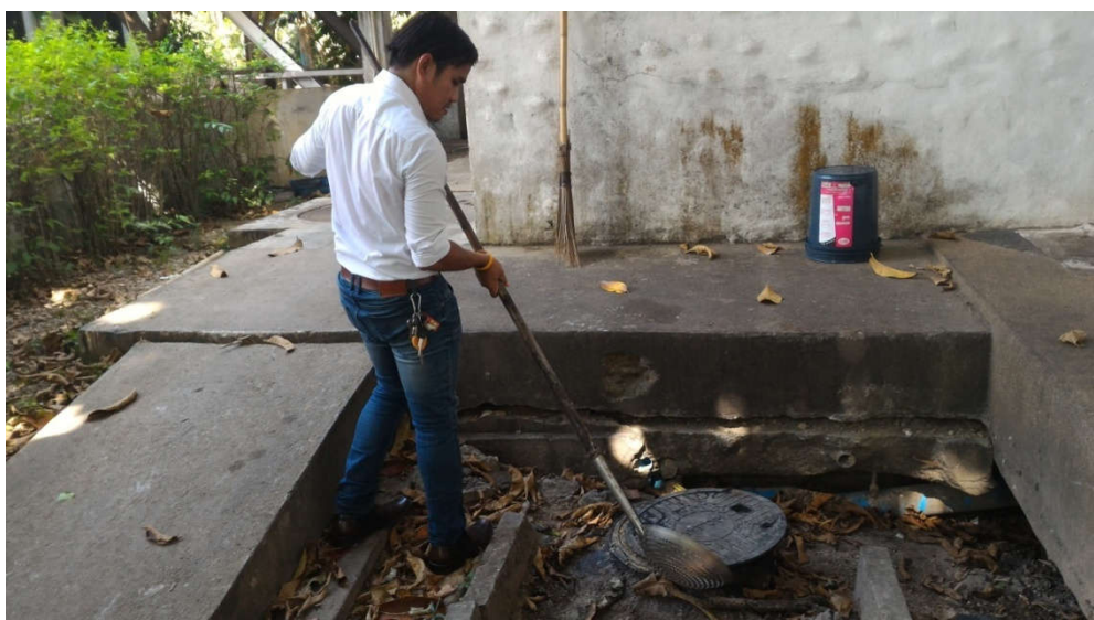
ภาพที่ 4.19 การดักไขมันจากถังดักไขมัน
