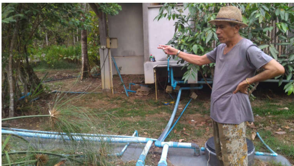
ภาพที่ 4.46 ถังบำบัดน้ำ-เสียขนาดใหญ่ของร้านเรือนไม้
