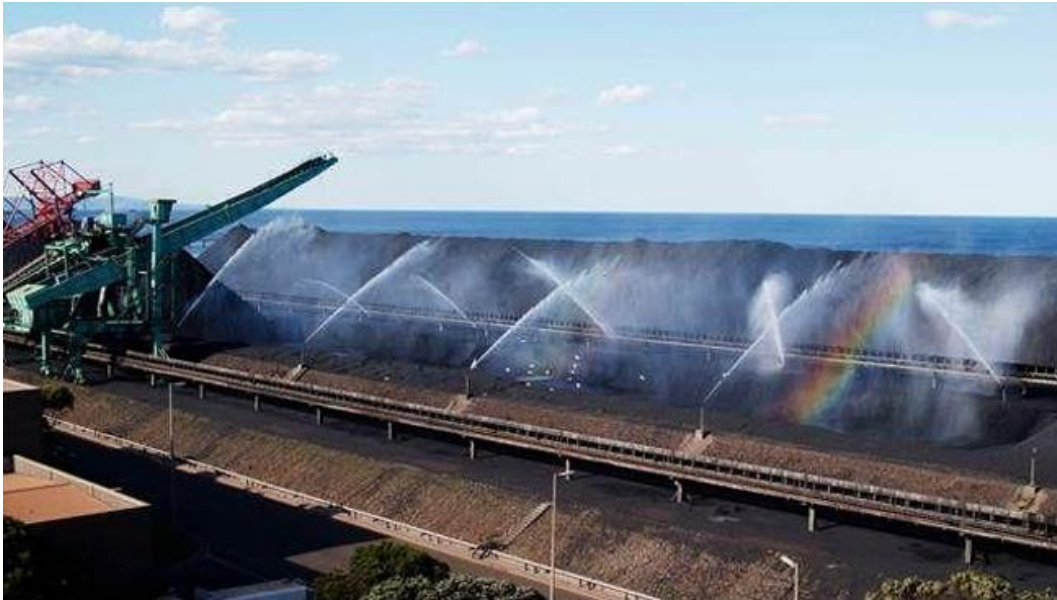
รูปที่ 6.3 การฉีดพ่นน้ำเพื่อควบคุมฝุ่นละอองที่กองเก็บเชื้อเพลิงถ่านหินด้วยระบบคอมพิวเตอร์ ที่ Port Kembla ประเทศออสเตรเลีย 10
