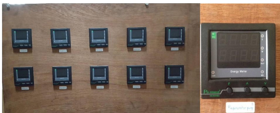
รูปที่ 53 Energy meter
