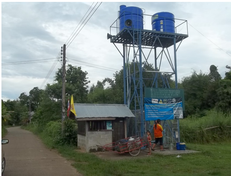
ภาพที่ 5 ระบบประปาของชุมชนบ้านท่างอย
