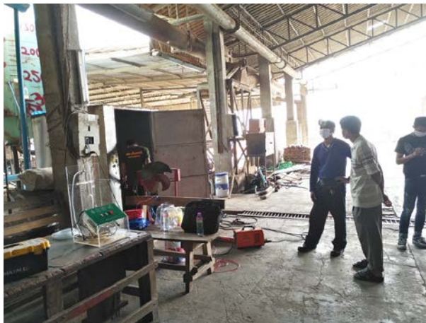
รูปที่ 4.12 การติดตั้งระบบควบคุมความเข้มข้นน้ำยาแบบอัตโนมัติที่บริษัทนครศรีพาราวู้ดจำกัด อำเภอเมือง จังหวัดนครศรีธรรมราช
