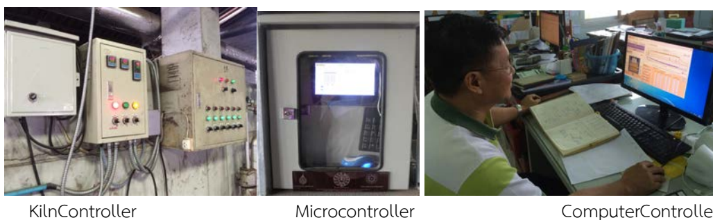
รูปที่ 2.18 ระบบควบคุมเตาอบไม้ ( DryWood : KilnController) ระบบควบคุมไมโครคอนโทรลเลอร์ ( DryWood : MicroController) และ ระบบควบคุมคอมพิวเตอร์ ( DryWood : ComputerController) แบบหลายเตาอบขณะใช้งานโรงงานแห่งหนึ่งในพื้นที่จังหวัดนครศรีธรรมราช
