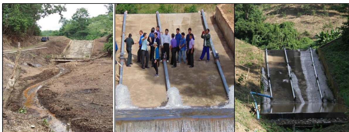
ภาพที่ 8-14 ระบบกักน้ำของ ต.เมืองจันท์ อ.ภูเพียง จ.น่าน โดยมีบ่อพวง 1 จุด และถึงกักเก็บน้ำ 10 จุด พร้อมระบบท่อส่งน้ำยาว 8 กม.
