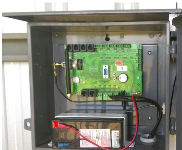
ภาพที่ 23 แสดงบอร์ด MMSIII รุ่น Gateway ซึ่งใช้ในโหมดควบคุมหลัก
