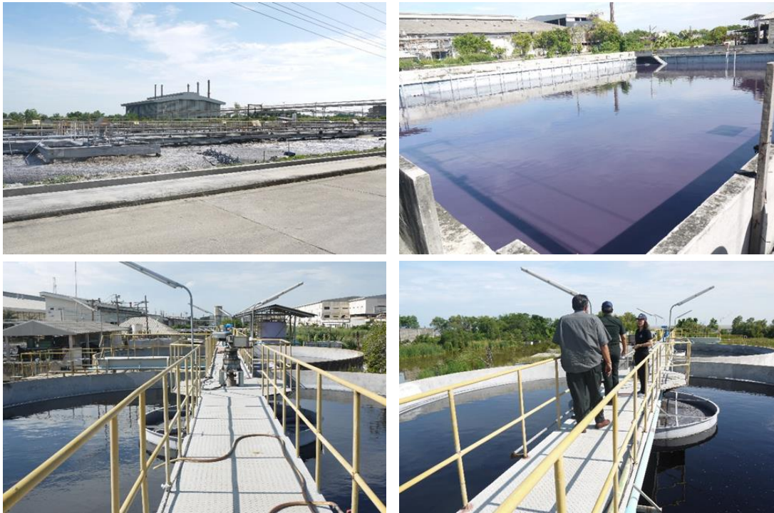
รูปที่ 4.4 รูปภาพแสดงระบบบำบัดน้ำเสียของโรงงานพอกย้อม
