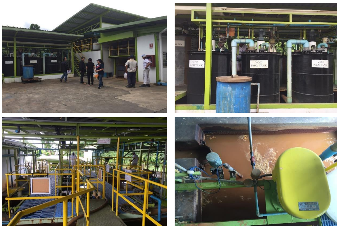
รูปที่ 4.15 รูปภาพแสดงระบบบำบัดน้ำเสียของโรงงานชุบโลหะ
