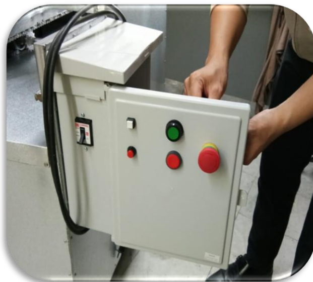
ภาพที่ 3.32 แสดงการตู้สวิตช์ต่างๆในตู้ควบคุม
