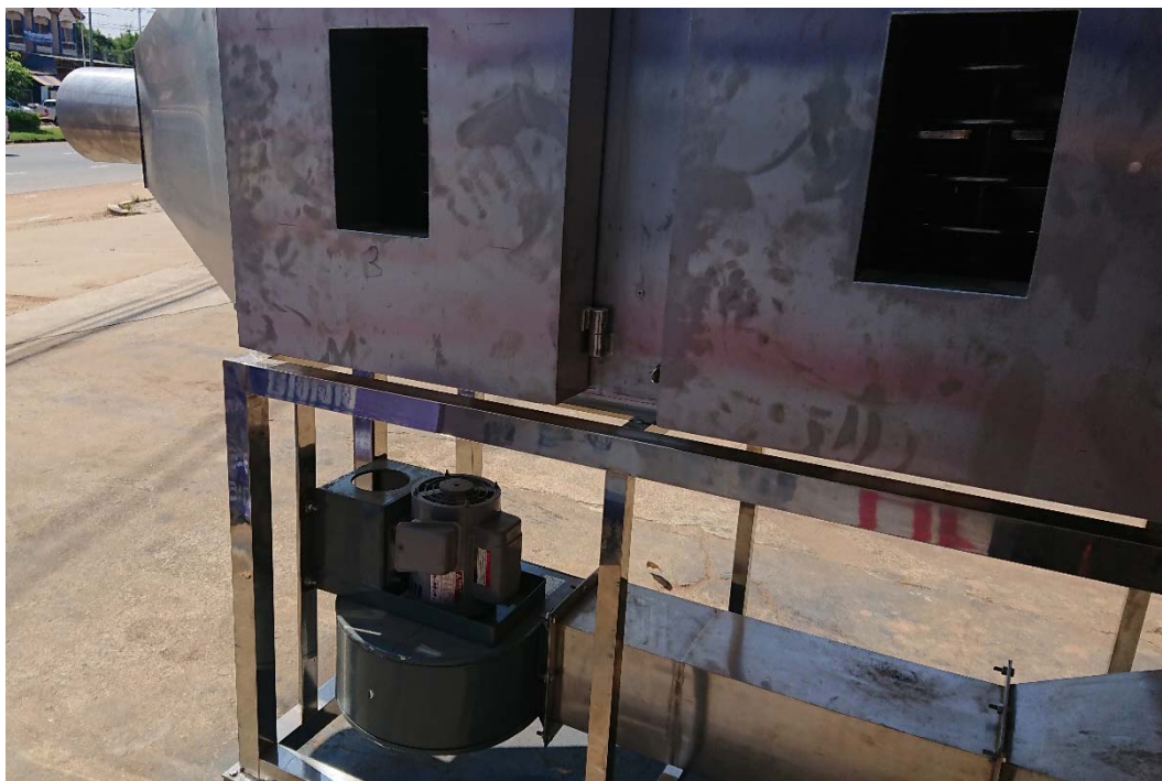
ภาพที่ 2 พัดลมและมอเตอร์ขนาด 0.75 kW
