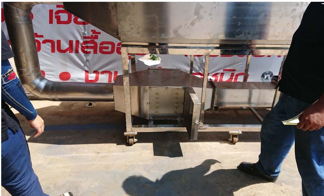
ภาพที่ 3 ชุด Heater ไฟฟ้า สำหรับอุ่นอากาศกำลังรวม 9 kW
