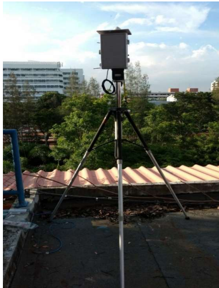
รูปที่ 3-19 อุปกรณ์สำรวจของสถานีฐาน ถูกติดตั้งบริเวณคาตฟ้าเพื่อรอการทดสอบใช้งานจริง
