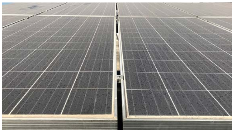
รูปที่ 3.49 แสดงลักษณะสิ่งสกปรกที่เกาะติดบนแผงเซลล์พลังงานแสงอาทิตย์ (โครงการผลิตไฟฟ้าจากเซลล์แสงอาทิตย์ชั้นนี้บางจาก Sunny bangchak)
