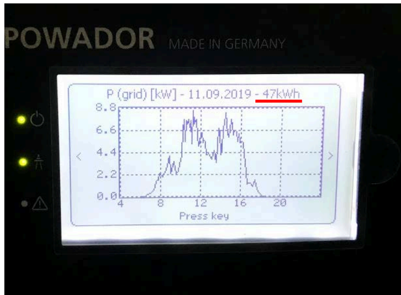
รูปที่ 4.56 แผงเซลล์แสงอาทิตย์ก่อนทำความสะอาดผลิตกระแสไฟฟ้าได้ 47 กิโลวัตต์ (kWh)
