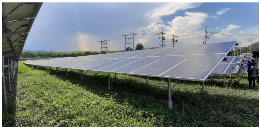
รูปที่ 3.56 แสดงลักษณะการติดตั้งแผงเซลล์พลังงานแสงอาทิตย์ (โครงการสหกรณ์โคนมสอยดาว)
