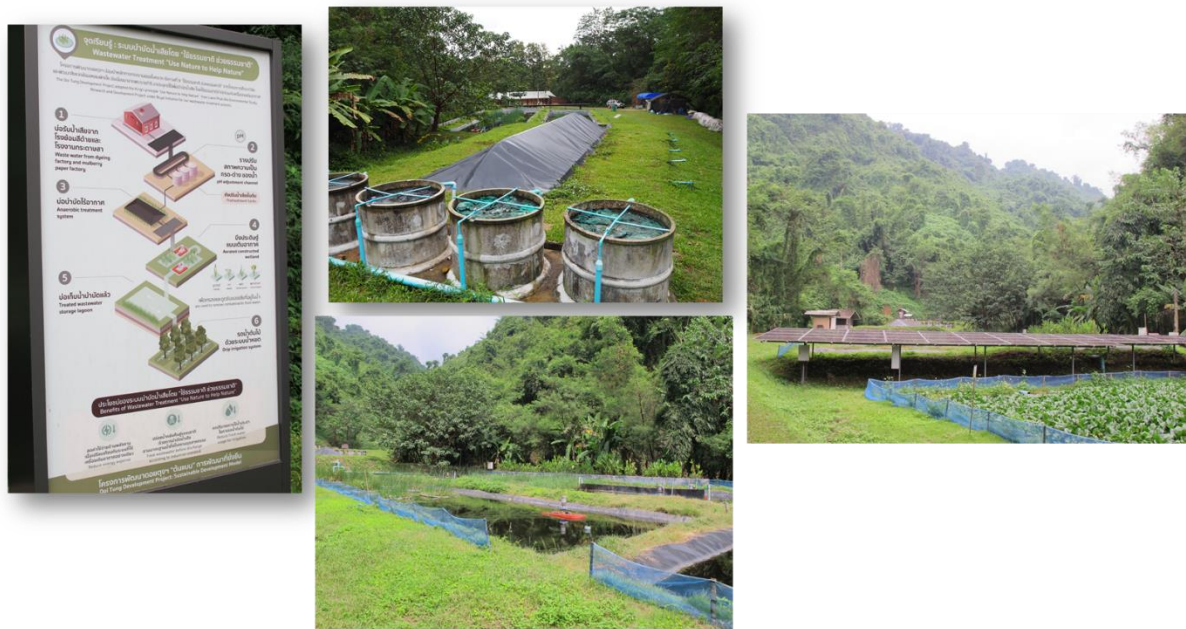
ระบบบำบัดน้ำเสียจากแหล่งน้ำทิ้ง ส่วนโรงย้อมกระดาษสา และโรงย้อมสีเส้นใยฝ้ายของทางโครงการพัฒนาออยตุง
