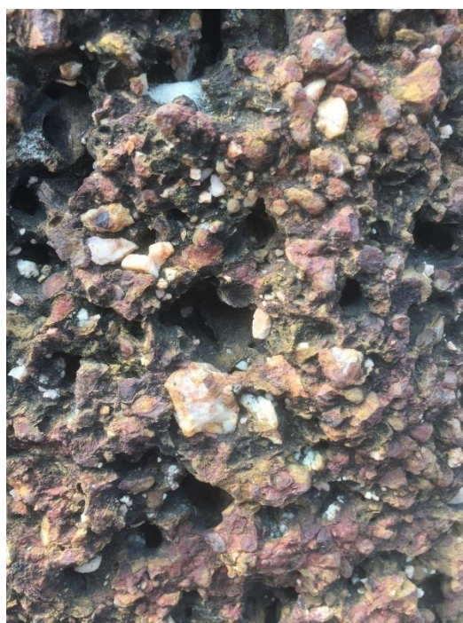
รูปที่ 2.13 เสาศิลาแลงกร่อนจนเห็นสภาพเม็ดหิน และเกิดตะไคร่และไลเคน (เสาศิลาแลงอุโบสถวัดสระศรี)
