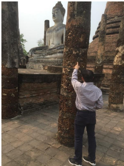
รูปที่ 2.12 เสาศิลาแลงอุโบสถวัดสระศรี มีสภาพกร่อน
