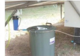
ตัวกรองน้ำเข้าถังพัก
