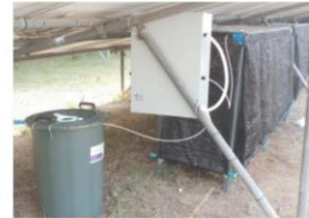
ถังพักน้ำและกล่องควบคุม
