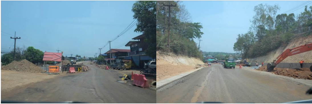
ภาพ 4-38 ทางหลวงเชื่อมโยงระหว่างประเทศหมายเลข 101 ช่วงจังหวัดน่าน – อำเภอเฉลิมพระเกียรติ ระหว่าง บ้านปอน – อำเภอเฉลิมพระเกียรติ ที่มา : คณะวิจัย
