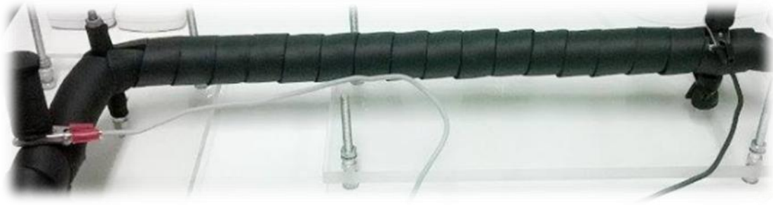
รูปที่ 10 Pre-heater
