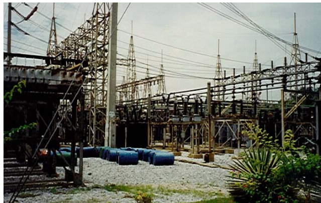
รูปที่ 3-17 ลานสวิตช์ 69 kV ของสถานีไฟฟ้าย่อยบางกะปิ
