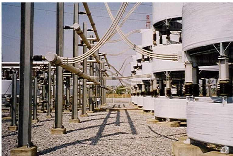
รูปที่ 3-13 บริเวณ Reactor-Capacitor bank ของสถานีไฟฟ้าแรงสูงท่าตะโก
