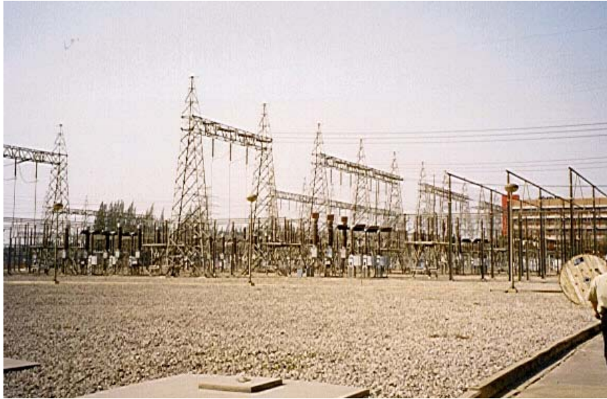
รูปที่ 3-7 ลานสวิตช์ 500 kV ของสถานีไฟฟ้าแรงสูงแม่เมาะ
