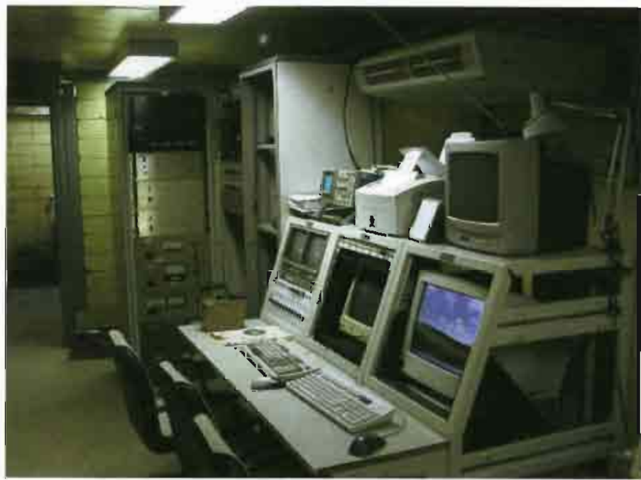
รูปที่ 3.34 ห้องควบคุมและส่วนควบคุมต่าง ๆ
