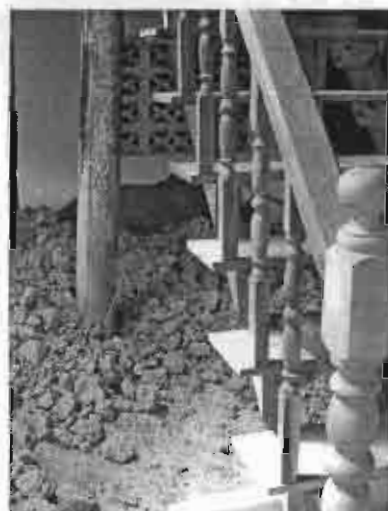
รูป 2.17 ดาเหลวที่เสานักบันไดขึ้นเรือน
