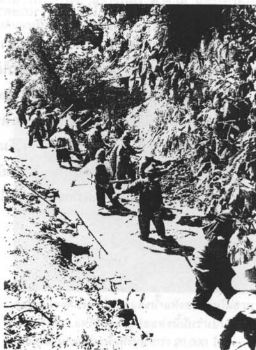
ในฤดูน้ำหลาก ลำเหมืองหลวงมักถูกน้ำแม่แจ่มขึ้นท่วมเสียหาย เงินที่ใช้ในการซ่อมแซมส่วนหนึ่งมาจากค่าน้ำที่เก็บจากลูกเหมือง
