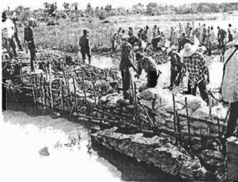
ลูกเหมืองมาช่วยกันซ่อมแซมลำเหมือง ที่เสียหายเนื่องจากน้ำป่าไหลทะลักเข้าลำเหมือง
