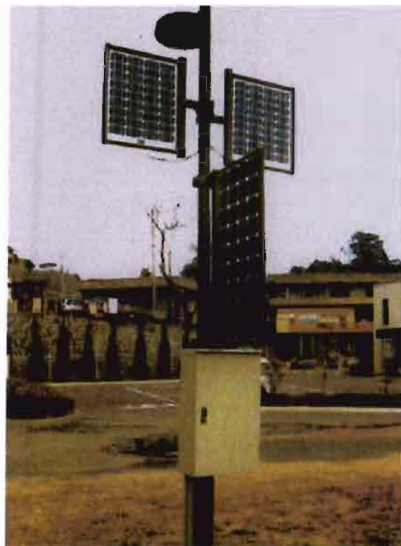
เสาไฟฟ้าพลังงานแสงอาทิตย์
