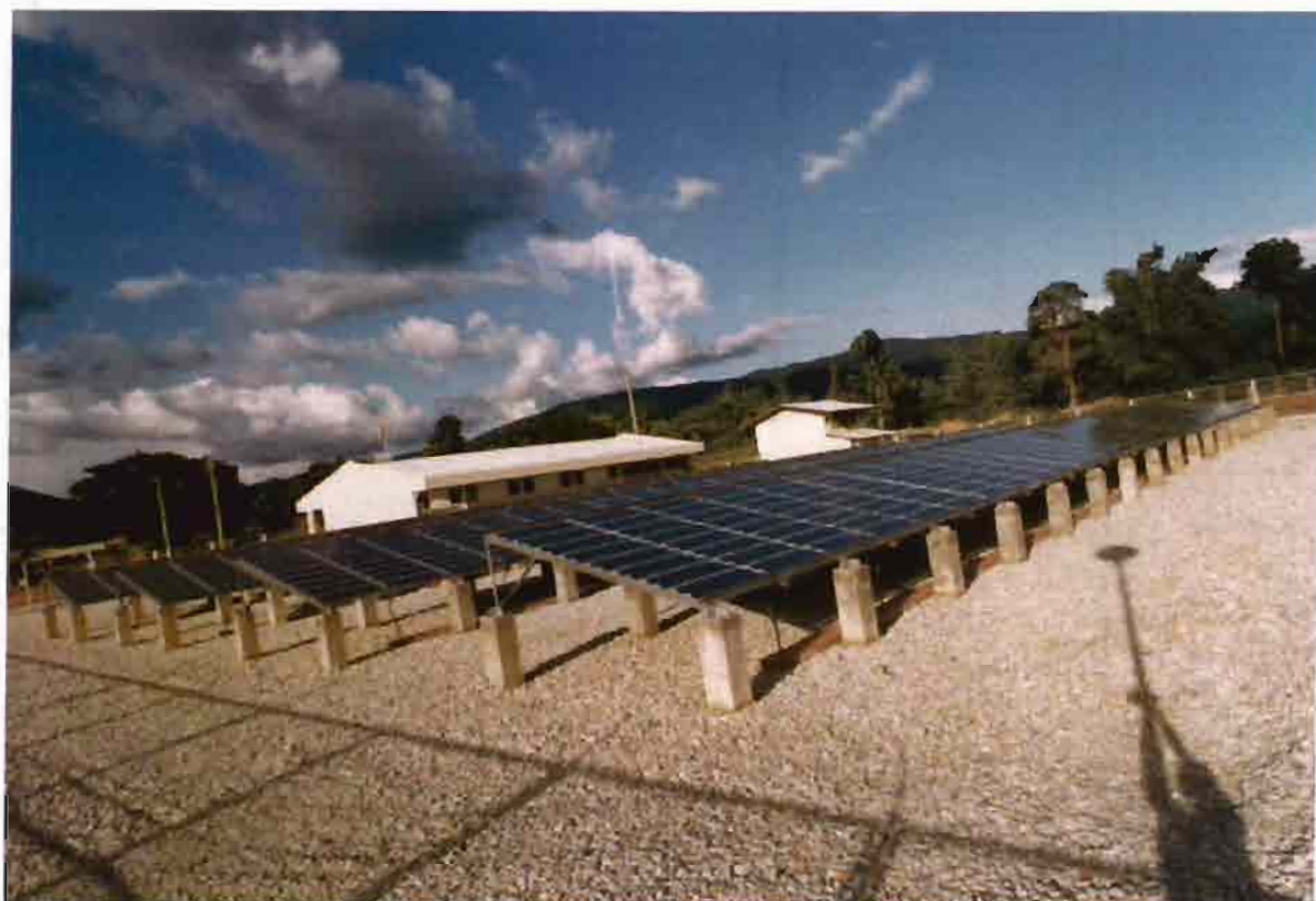
สถานีไฟฟ้าพลังงานแสงอาทิตย์
