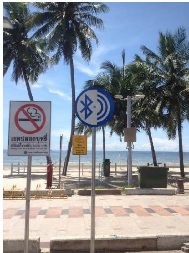
รูปที่ 4.1-23 ตำแหน่งการติดตั้ง blueBLE SignPost บริเวณศาลเจ้าพ่อเสือ
