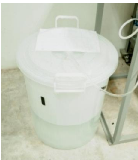
รูปที่ 18 ถังเก็บน้ำ
