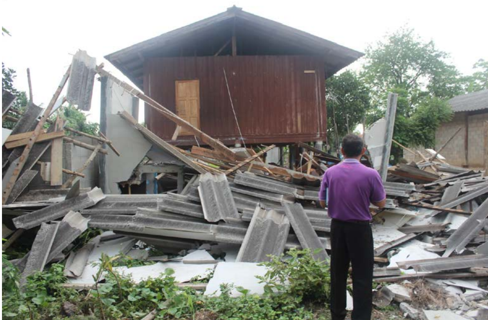
รูปที่ 6. ลักษณะความเสียหายของอาคารที่ได้รับความเสียหายประเภทที่ 2 โดยอาคารทั้งหลังถล่มเนื่องจากเสามีขนาดเล็กเกินไป โดยบ้านไม้ที่มีความเบากว่าด้านหลังไม่ได้รับความเสียหาย
