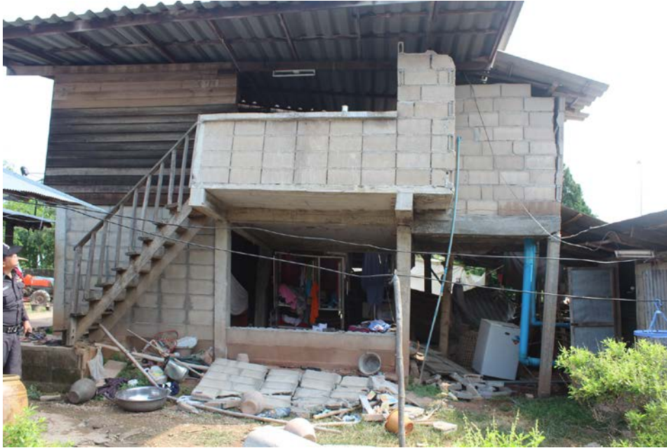
รูปที่ 5. ลักษณะความเสียหายของอาคารที่ได้รับความเสียหายประเภทที่ 2 โดยผนังคอนกรีตบล็อกบนอาคารพื้นยกสูงพังถล่ม (Out-of-plane failure) และ โครงสร้างเซเนื่องจากเสามีขนาดเล็กเกินไป
