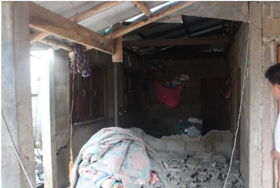
รูปที่ 2. ลักษณะความเสียหายของอาคารที่ได้รับความเสียหายประเภทที่ 1 โดยผนังคอนกรีตบดล็อกพังถล่ม (Out-of-plane failure)
