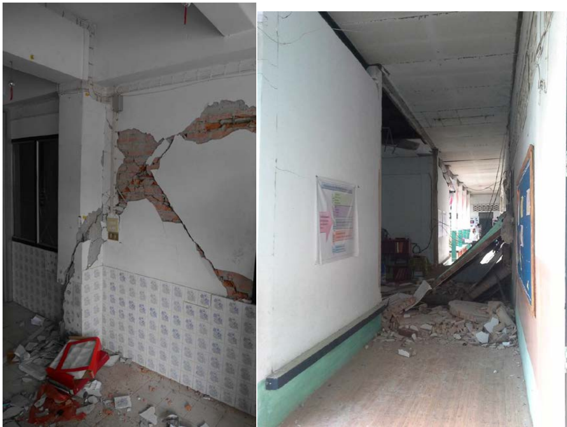
รูปที่ 8. ลักษณะความเสียหายของอาคารที่ได้รับความเสียหายประเภทที่ 3 โดยผนังอาคารแตกทำให้เสาเกิดความเสียหาย (รูปซ้าย) โดยผนังอาคารที่ไม่ได้มีการยึดรั้งที่ดีและมีขนาดใหญ่ถล่มออกมาจากแนวเสา (รูปขวา)
