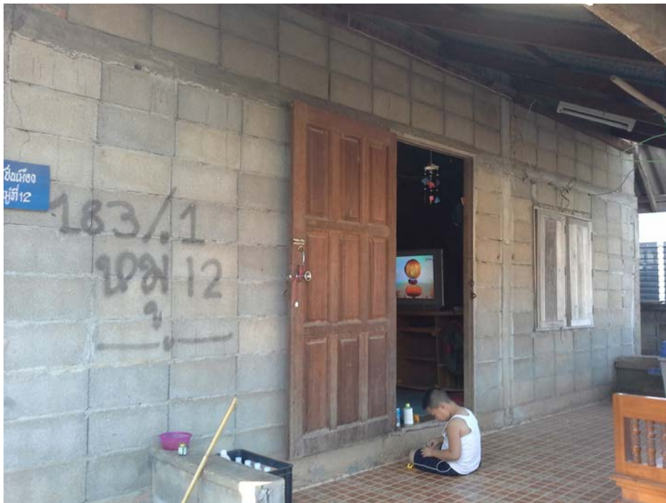
รูปที่ 3. ลักษณะการซ่อมแซมความเสียหายของอาคารที่ได้รับความเสียหายประเภทที่ 1 โดยผนังคอนกรีตบดล็อกขนาดใหญ่ถูกใช้บนที่สูงจึงเสี่ยงต่อการหล่นทับผู้อยู่อาศัยภายในอาคารประเภทนี้
