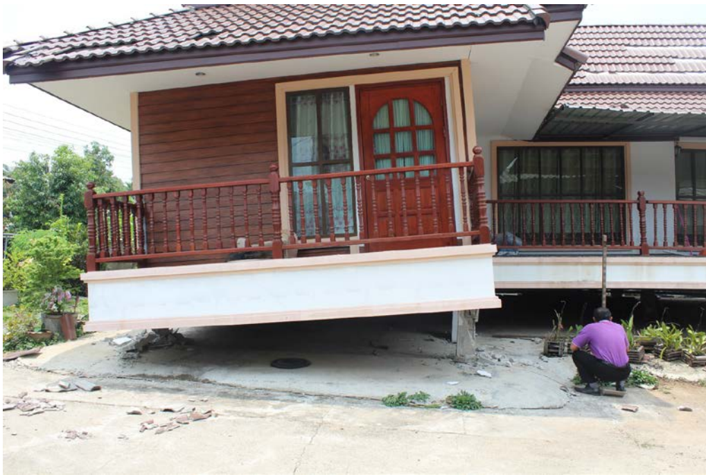
รูปที่ 7. ลักษณะความเสียหายของอาคารที่ได้รับความเสียหายประเภทที่ 3 โดยเสาชั้นล่างของอาคารฉีกขาดเนื่องจากเสามีขนาดเล็กเกินไป
