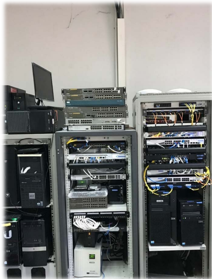
รูปที่ 4.16 ห้อง Server Room
